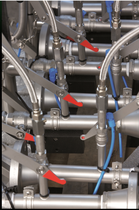
selbstentleerende Notdusche Detail Wasserauslass
